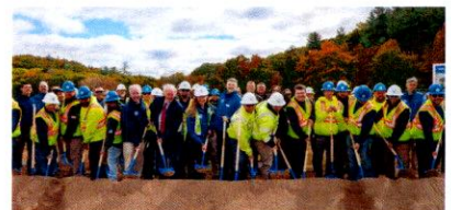
Funcionarios federales, estatales y locales se reúnen con empleados de la Comisión en la ceremonia de inicio de la nueva Planta de Tratamiento de Agua de West Parish en octubre de 2024.
